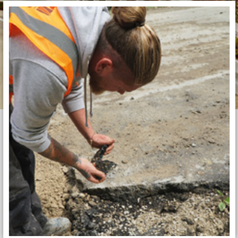
Die Straße war über die Jahre immer wieder überasphaltiert worden und brauchte dringend eine Sanierung
